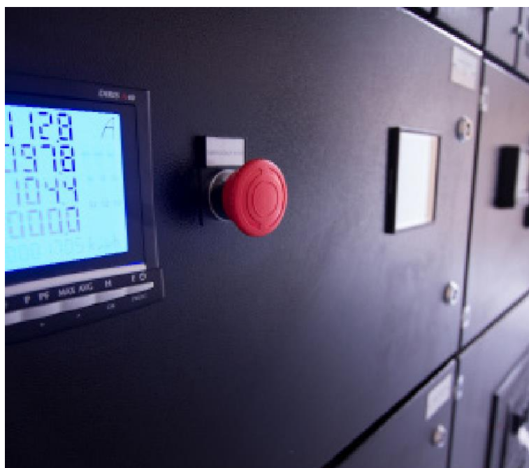
Photo : Appareillage de connexion électrique du circuit « A » dans notre centre de données
