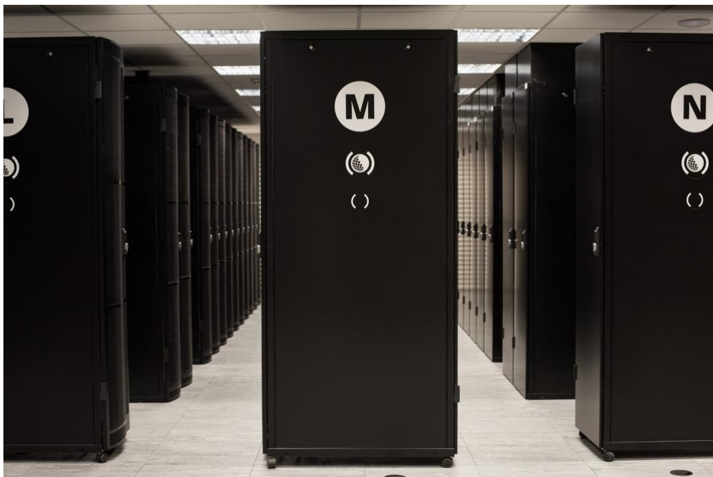
Photo : Installation de baies dans notre centre de données Amen
